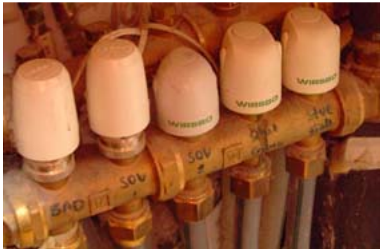
Tresostater/varmefordeler gulvvarme (gjelder 1.etg.)
